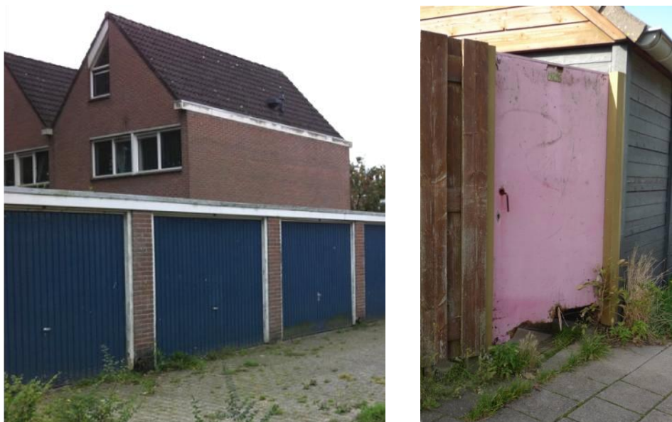
Foto 3.1 Technische slijtage in Bargeres (links) en Middelzand (rechts)
